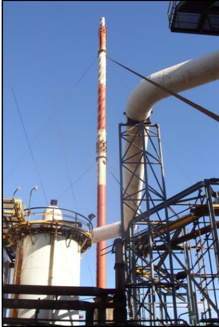
Fig. 9 – Chimenea de planta química
